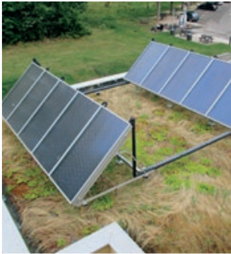
Panneaux solaires photovoltaïques sur une toiture plate.
